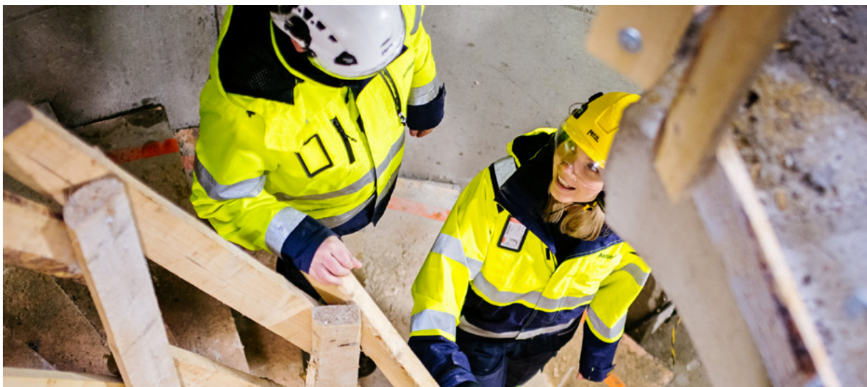
En utmaning för Assemblin är att våra beställare har olika säkerhetskrav. Vi har därför infört en egen minimistandard för personlig skyddutrustning på byggarbetsplatser som gäller oavsett vad våra uppdragsgivare kräver.
